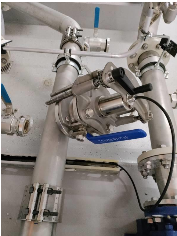
Messsonde in der Faulschlammleitung
