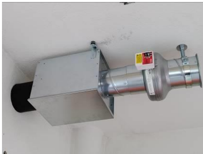
Lüftung PW Schornen
