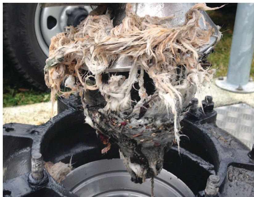
Verstopfte Pumpen, aufwändige Instandstellung.
